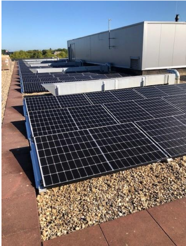
pv-panelen op het dak van de Eeuwsels
